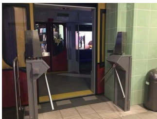
Ein- und Ausgangsschranke
